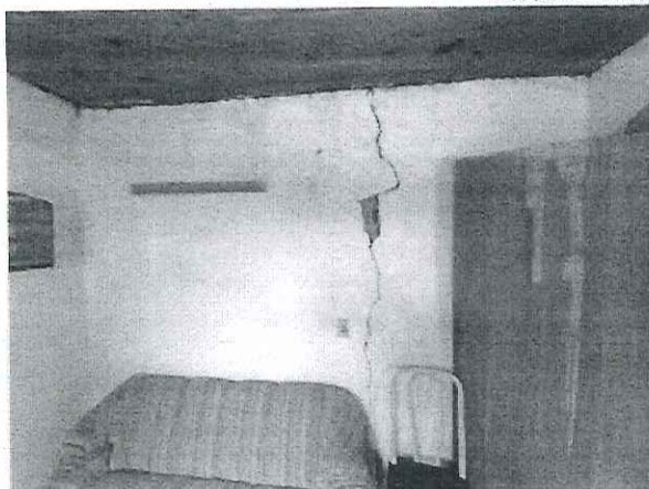
Rachadura na alvenaria
