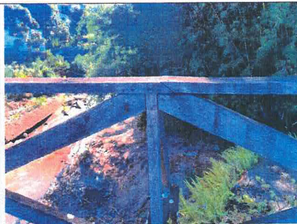
Imagem 4: Ausência de fixação e deterioração de guarda-corpo
