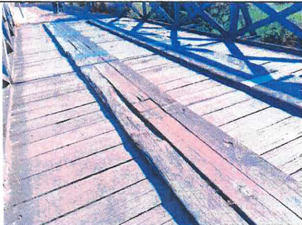
Imagem 5: Ausência de chapas metálicas de fixação
