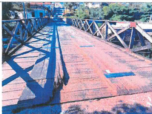
Imagem 1: Deterioração dos pranchões longitudinais
