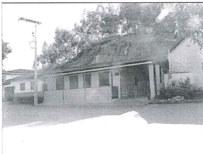
Foto 239 – Vista frontal do setor de risco e dos indicativos de movimentos de massa ocorridos no talude nos fundos dos domicílios.
