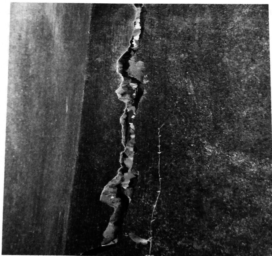
Trinca no muro não derrubado
