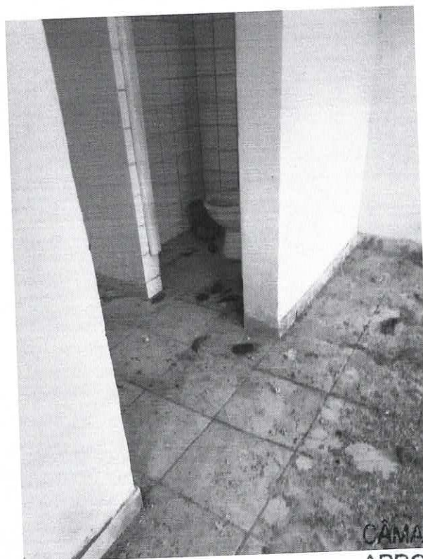
Banheiro do Vestiário danificado
