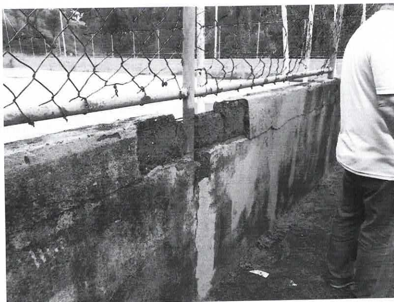
Muro da quadra de esportes quebrado
