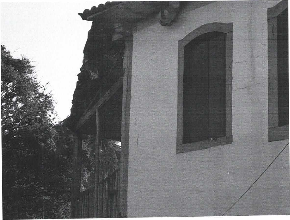
Trincas nas paredes do Casarão
