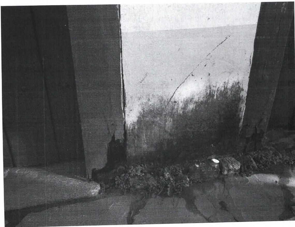
Portas do Casarão com trincas e danificadas
