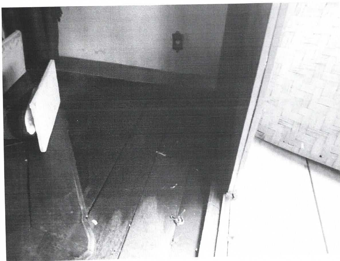
Piso (Assoalho) do Casarão danificado
