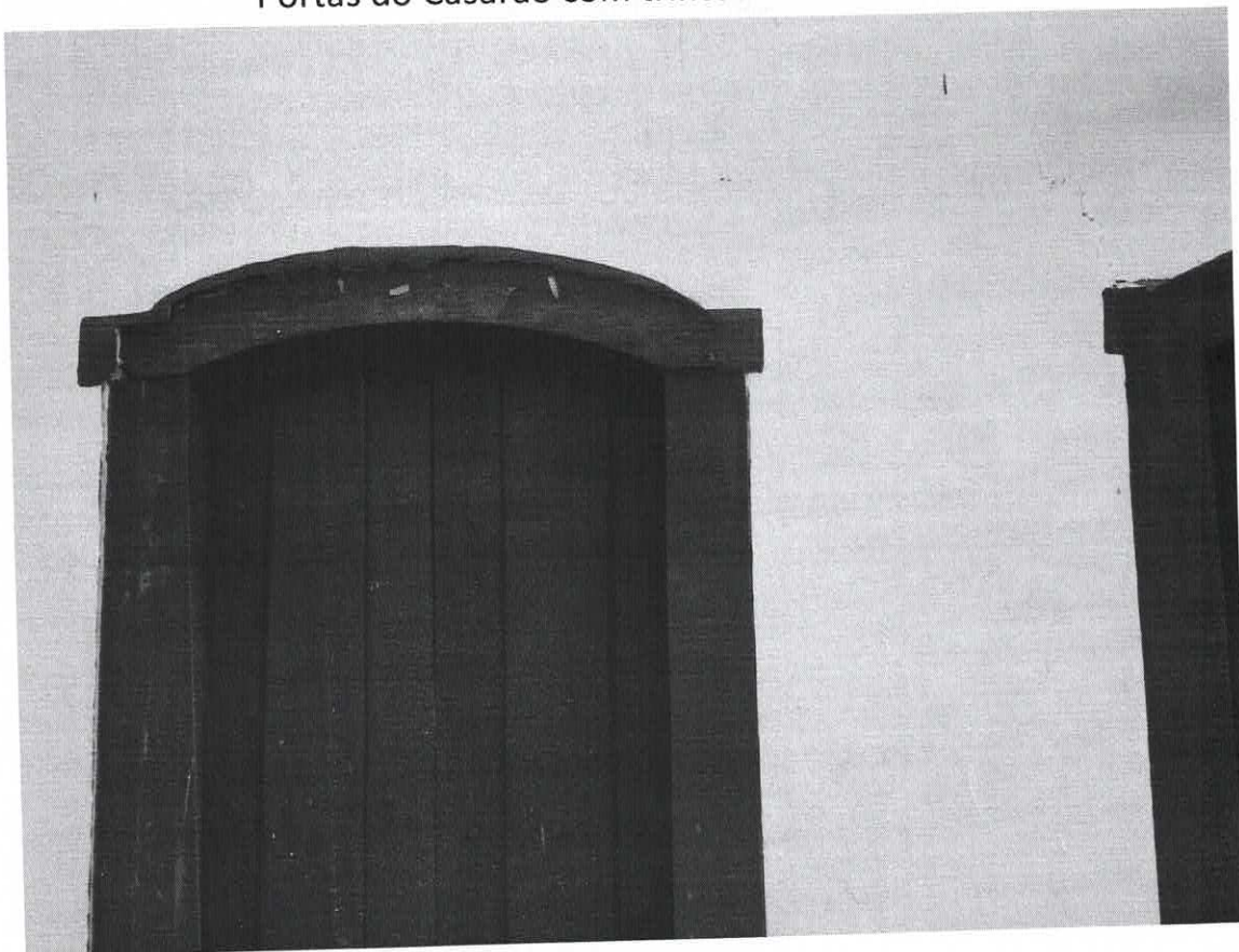
Portas do Casarão com trincas e danificadas
