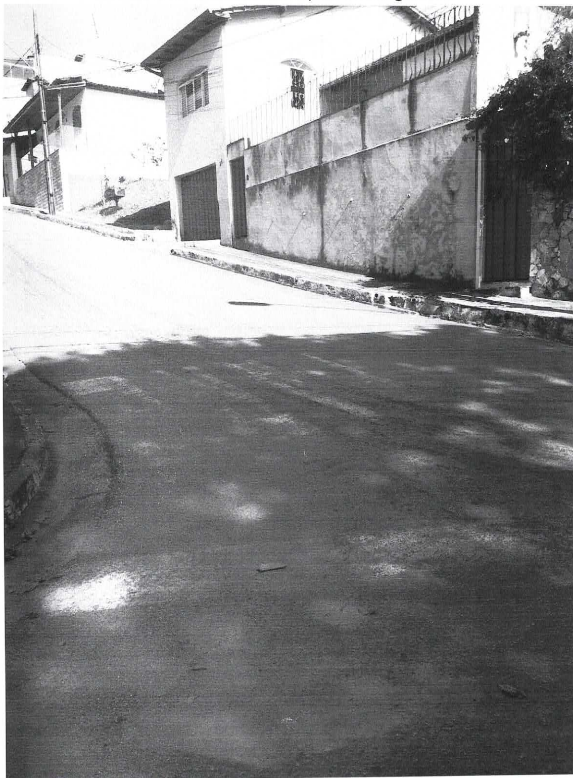
Faixa de trânsito com a pintura desgastada
