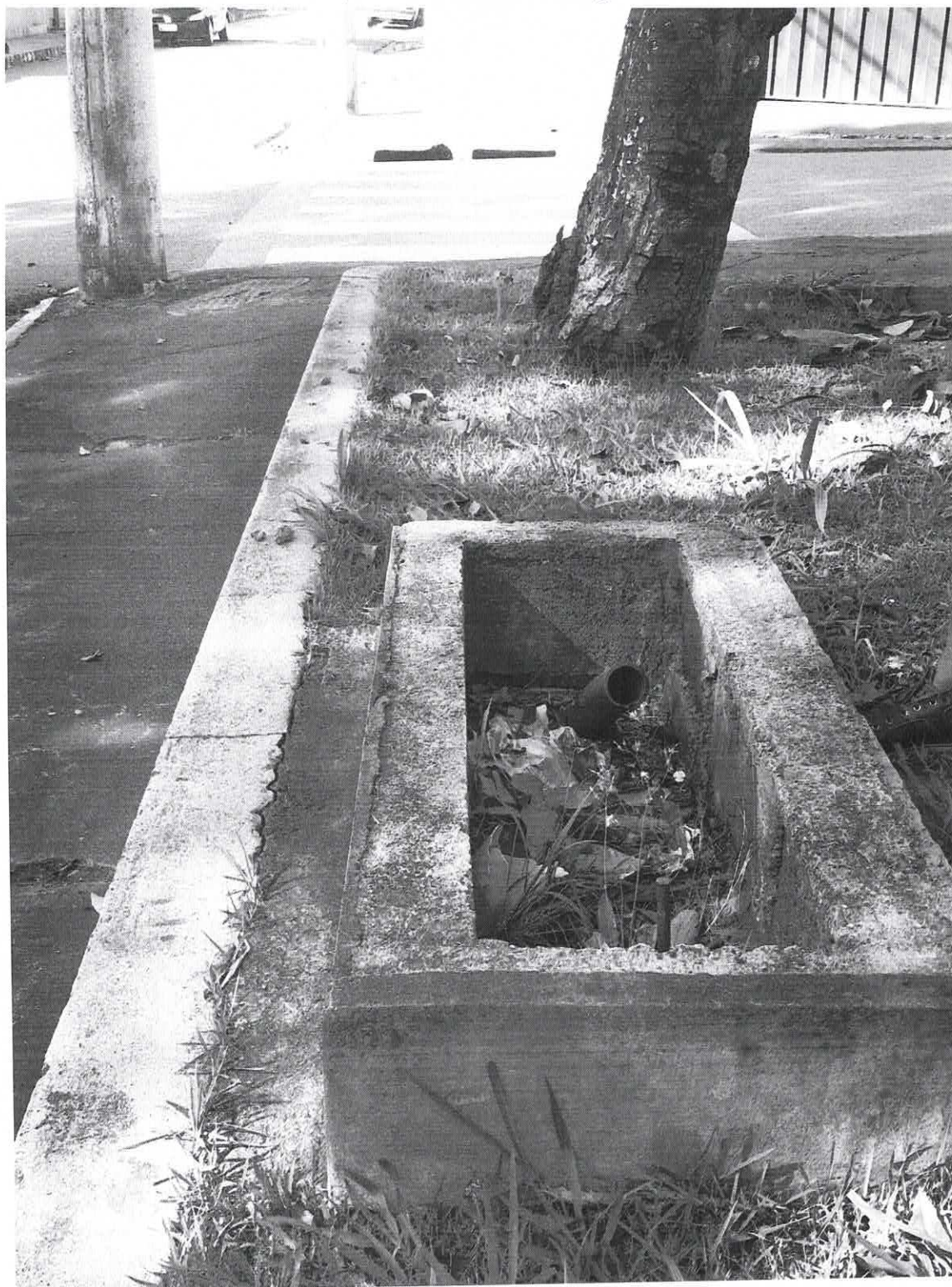
Falta tampa em caixa de energia elétrica
