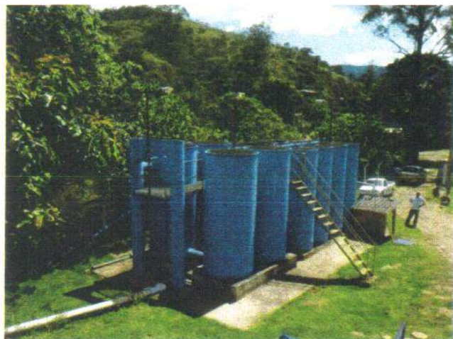
Foto 5.29 – Vista da ETA Matadouro
