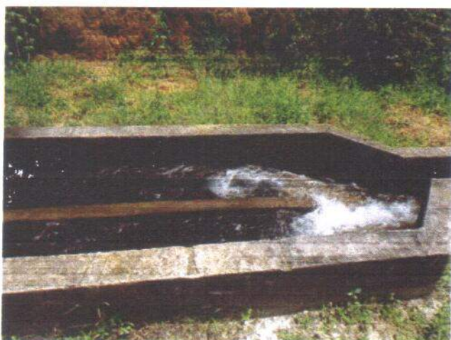
Foto 5.36 – Caixa de areia
