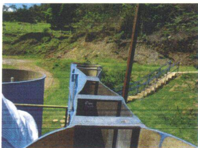
Foto 5.31 – Chegada de água bruta na ETA Matadouro
