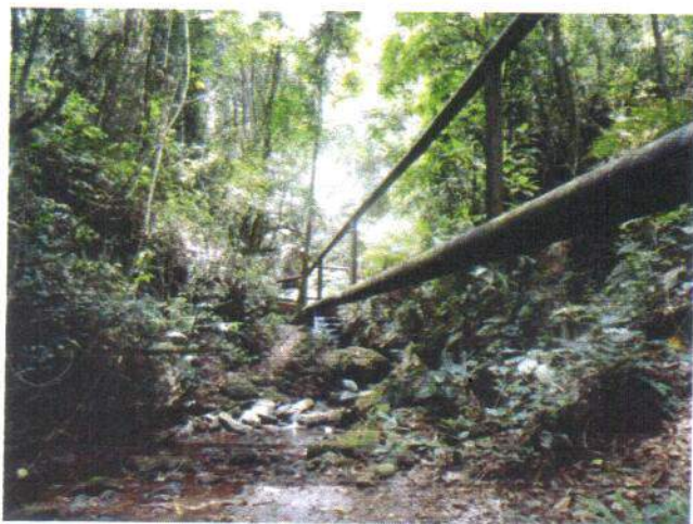
Foto 5.5 – Adutora do sistema (1)
