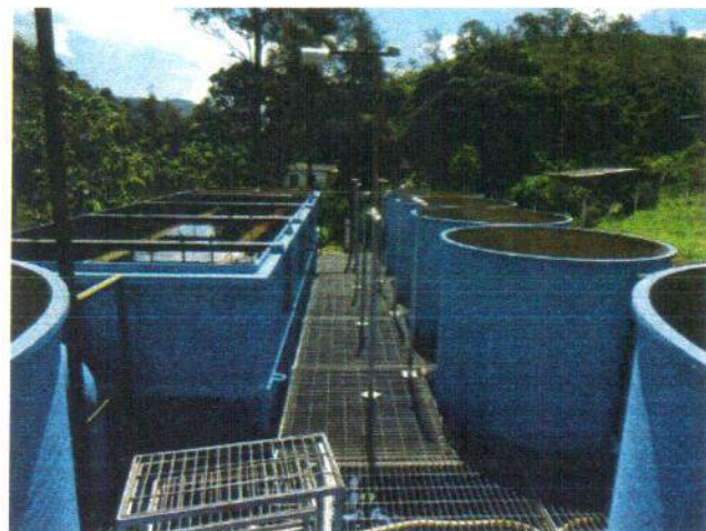
Foto 5.30 – Unidades da ETA Matadouro
