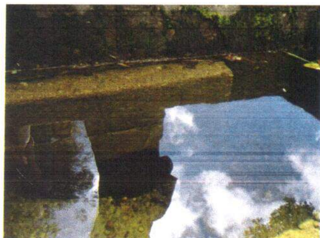
Foto 5.45 – Adutora da Captação Serrinha 2
