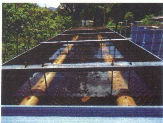
Foto 5.33 – Decantador da ETA Matadouro
