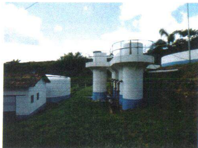
Foto 5.20 – Vista da ETA Mata do Seminário (2)
