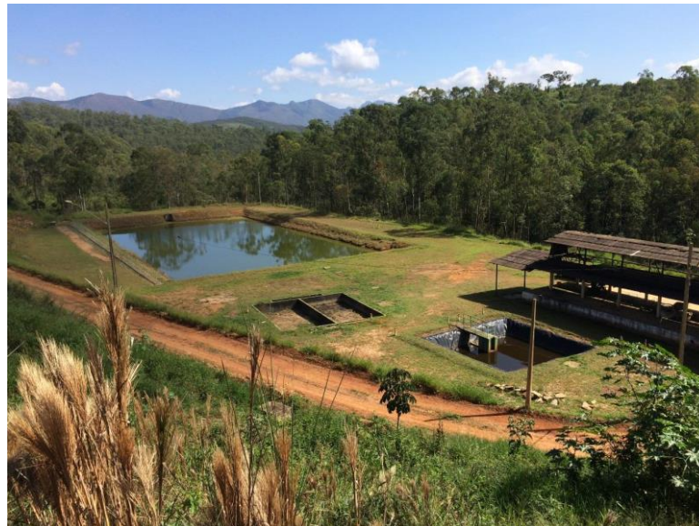
Figura 63 – Estação de tratamento para chorume do aterro sanitário. Fonte – CAVO, 2017
