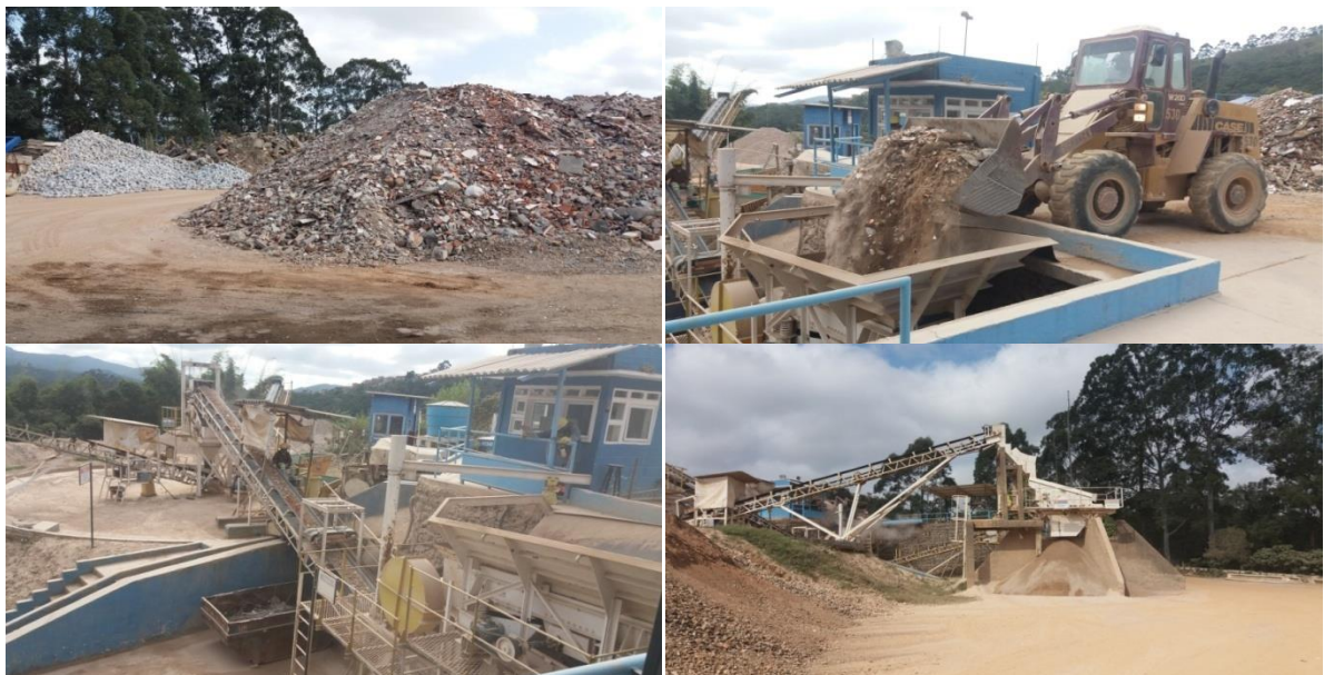
Figura 8 - Visualização geral do beneficiamento de resíduos da Usina Proguaru. Fonte – PIMENTA et al., 2017
